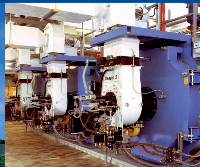
Heizzentrale Zeiss, Oberkochen
