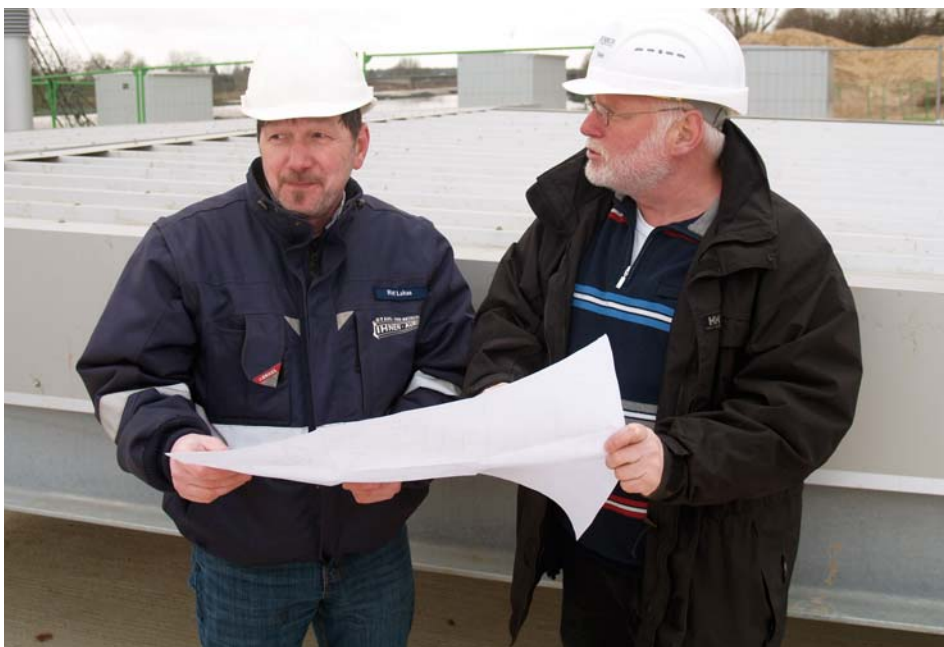
Rolf Lukas (links) von IHNEN AURICH und Bauleiter Karl Ihmels, ENERCON, vor den Stahldächern über dem Krafraum.
